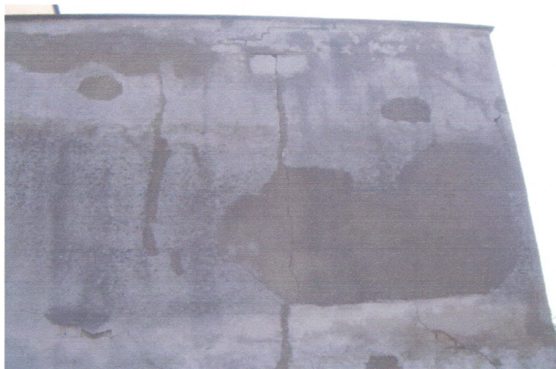
Gryfice, ul. Orzeszkowej 3 – dobudowany fragment oficyny -elewacja zachodnia (widoczne liczne zarysowania i popękania ściany)
