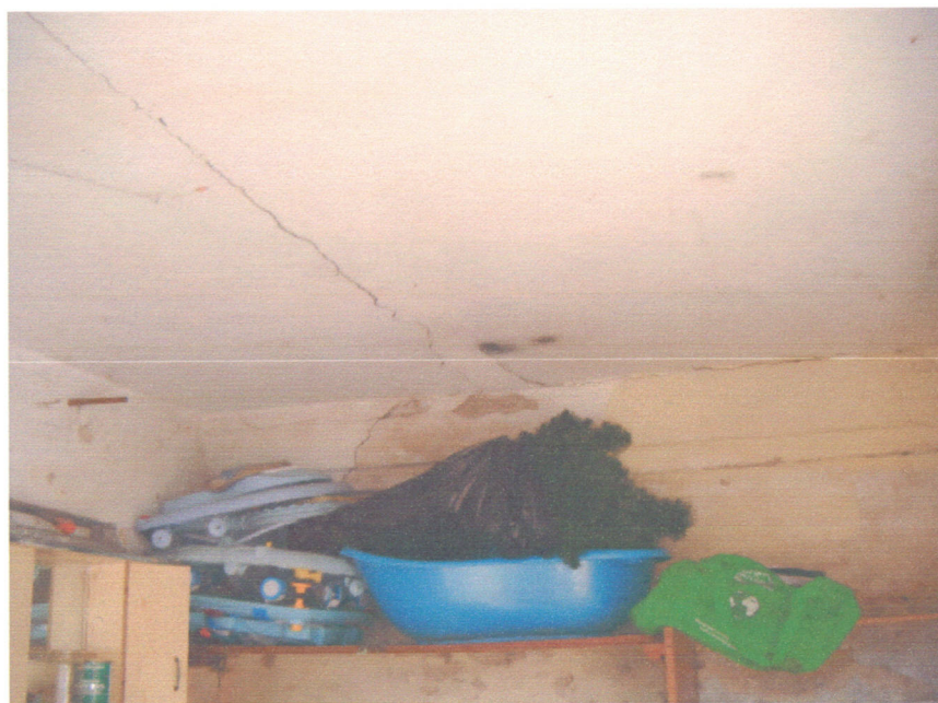
Gryfice, ul. Orzeszkowej 3 – dobudowany fragment oficyny – parter obiektu (widoczne zarysowania stropu i ścian)
