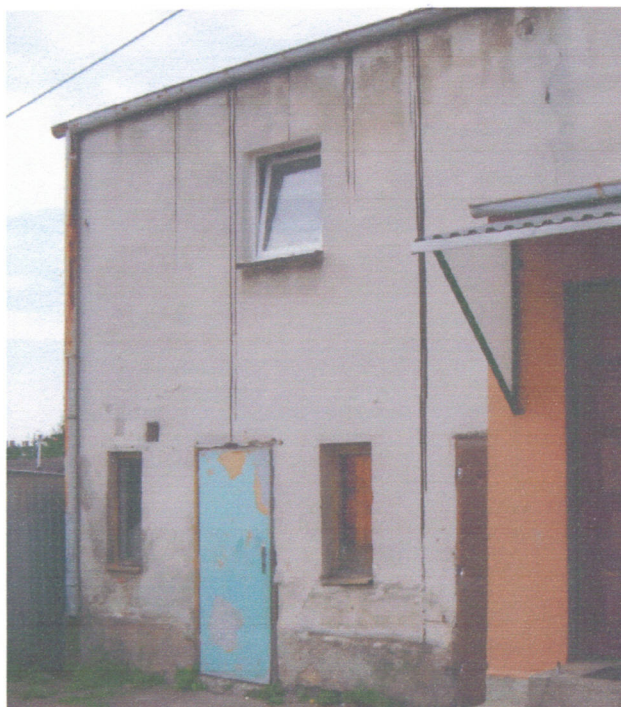
Gryfice, ul. Orzeszkowej 3 – dobudowany fragment oficyny -elewacja wschodnia (widoczne zarysowanie na styku ścian)
