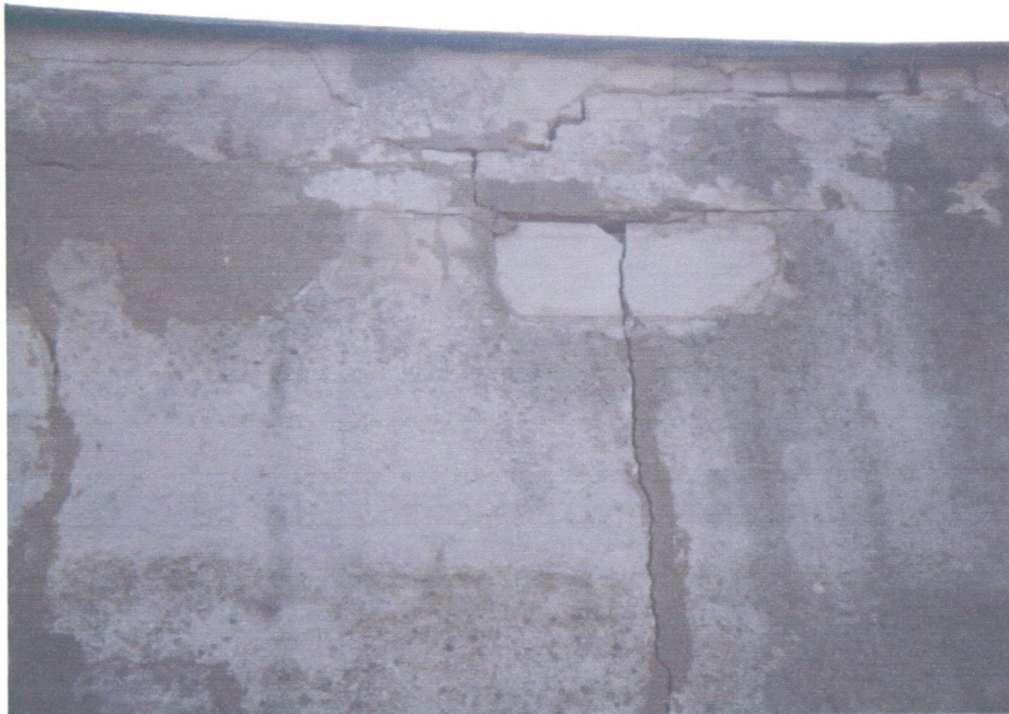
Gryfice, ul. Orzeszkowej 3 – dobudowany fragment oficyny -elewacja zachodnia (widoczne liczne zarysowania i popękania ściany)
