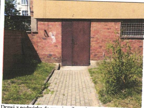
Drzwi z podwórka do wymiennikowni. Nie ma innego wejścia do tego pomieszczenia. Utwardzenie terenu działki 33/11
