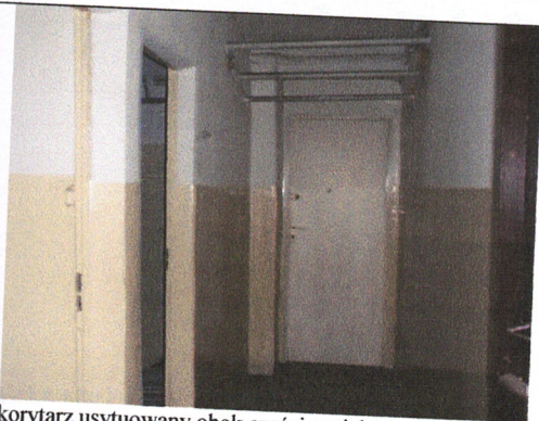
korytarz usytuowany obok części socjalnej i pompowni wiodący do korytarza ogólnego podpiwniczenia tego budynku.
