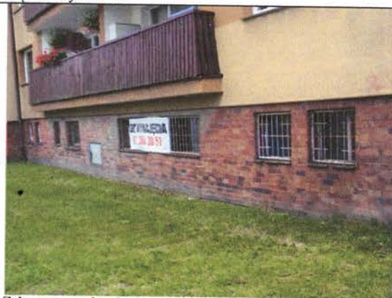
Zakratowane okna kotłowni CO.
