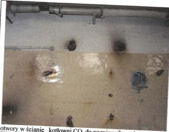
otwory w ścianie kotłowni CO do wymiennikowni
