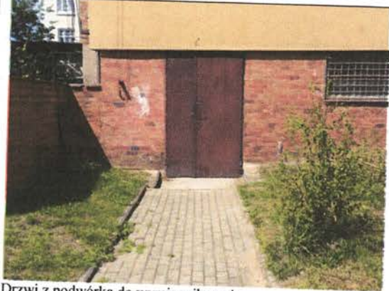
Drzwi z podwórka do wymiennikowni. Nie ma innego wejścia do tego pomieszczenia. Utwardzenie terenu działki 33/11
